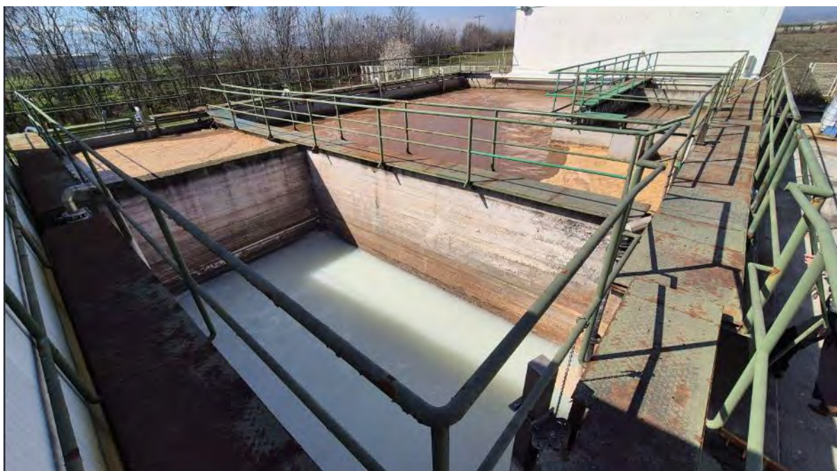
Слика бр: 38 Прочистителна станица
