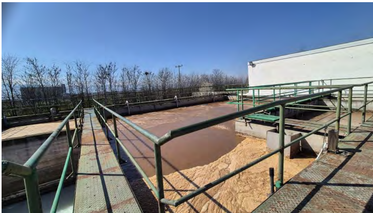
Слика бр: 39 Прочистителна станица
